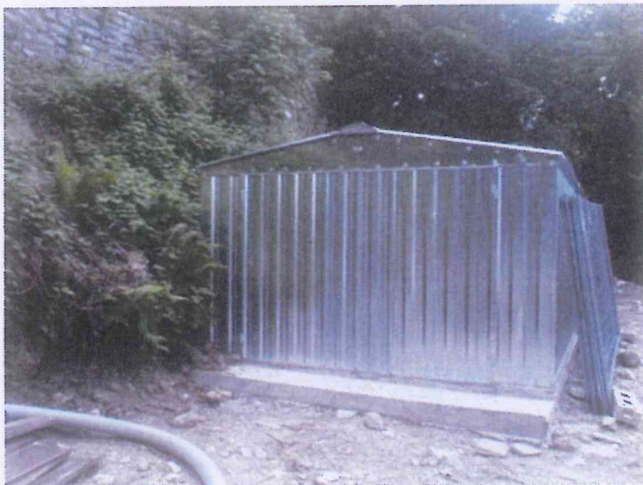
Scarpata in prossimità nuova baracca
